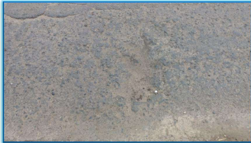
Figura 5: Deformaciones Superficiales. Fuente (propia)
