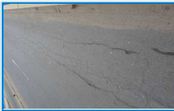
Figura 15: Grieta longitudinal y transversal: Fuente (propia)
