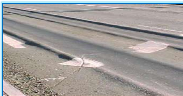
Figura 20 Ahuellamiento Fuente (Manual PCI)
