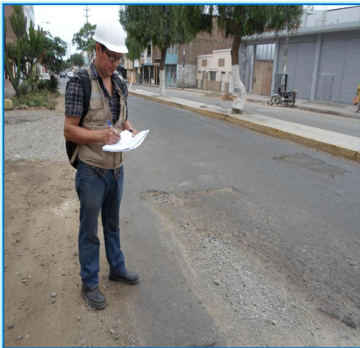
Foto N°3 Llenando la guía de observación frente a la falla encontrada en la sección de la vía estudiada.
