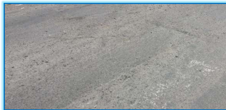
Figura 5: Desprendimientos de material asphaltico Fuente: (propia)
