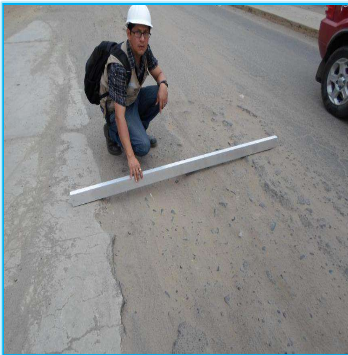
Foto Nº 5 Utilizando la regla de aluminio para determinar el nivel de severidad de las fallas
