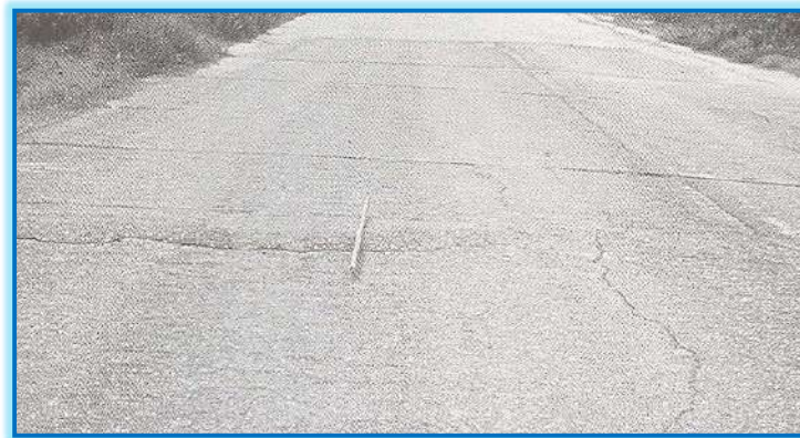
Figura 23 Hinchamiento Fuente (Manual PCI)
