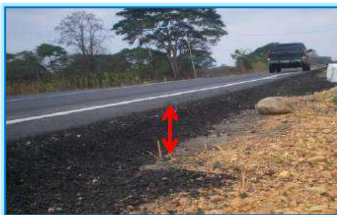
Figura 14 Desnivel de calzada
