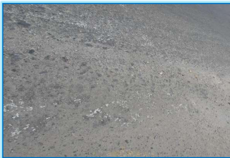
Figura 24: Desprendimiento de agregados: Fuente (propia)
