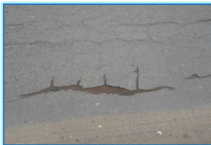
Figura 8: Agrietamiento en Bloque
