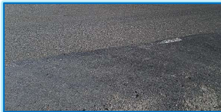
Figura 07: Falla por Exudación
